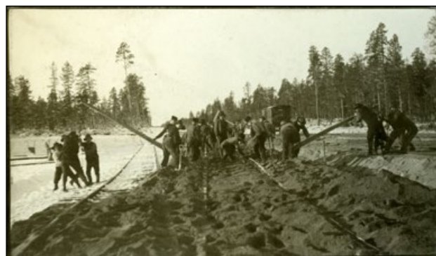
Spårlyftning och grusstoppning på bangård, sträckan Bastuträsk – Skellefteå/Rönnskärsverken, ca 1910. Foto Järnvägsmuseet ( digitaltmuseum.se ).
